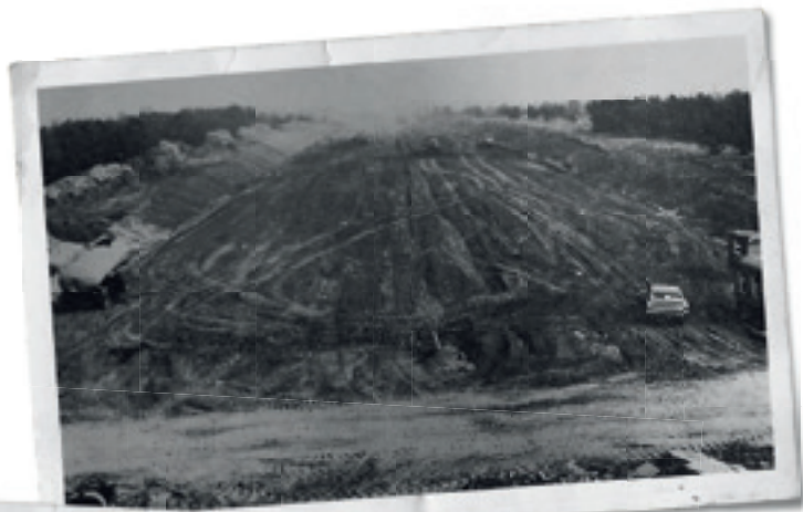
Start van de grondwerken van vak VI van de E39 in Maasmechelen.
